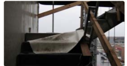
En af mange trappeopgange, hvor tæppet er løs, og det nødvendige rækværk mangler - 2. etage.
