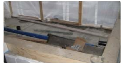
Stort vinduesparti på 2. etage, hvor rækværket er fjernet og der er frit fald.
