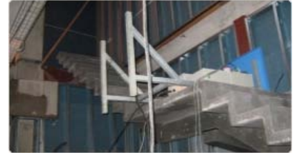
Adgangsvej uden rækværk og med el-tavle midt på trappen.
