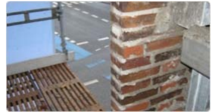
Sundhedshus uden rækværk og med frit fald fra 2. etage ned på trafikkeret vej i Horsens.
