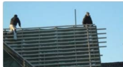
Arbejde på tagryg - uden sikkerhed. Billedet er taget af en af konsulenterne fra Byggeriets Arbejdsmiljøbus.
