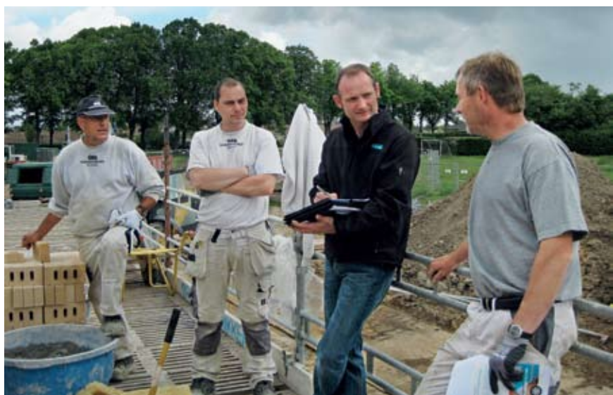
Lars Olsen tager en snak om tunge løft og nye regler på murerarbejde med et murersjak på en byggeplads i Præstø. Her er det underentreprenør P.S. Murerentreprise ApS, der er i gang med opmuringsarbejde.
